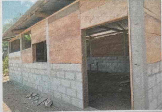
Foto 2: Con la imagen se hace notar la necesidad de mejorar el piso de la cocina.
