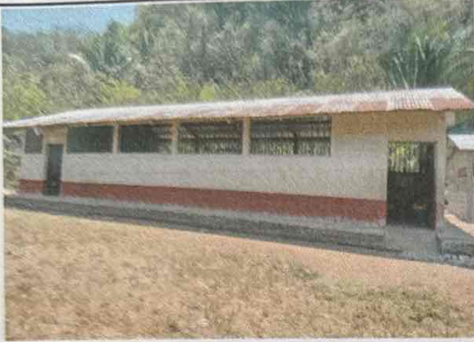
Foto1: En la imagen Se evidencia el deterioro del techo del edificio educativo
