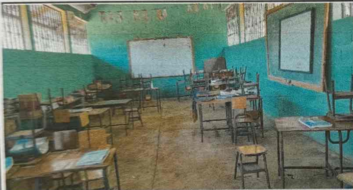
Foto 3: En la imagen se evidencia el mal estado del piso del edificio escolar.
